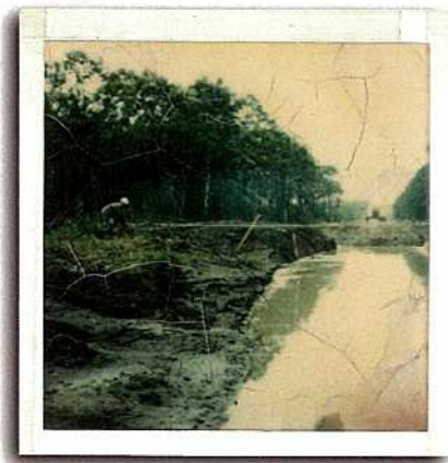
写真1 盛土破壊現場の事例
